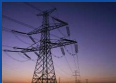
Электростанции и ЛЭП
