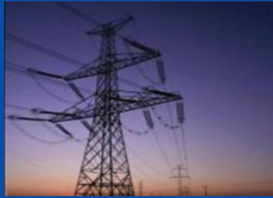
Электростанции и ЛЭП
